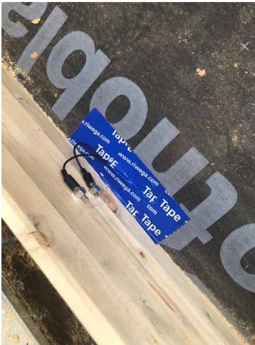
Sistema di monitoraggio installato su parete in x-lam posizionata su cordolo in acciaio
